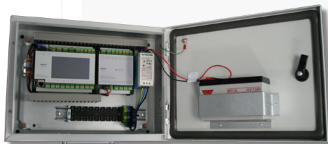
Stahlwandgehäuse, geöffnet, hier mit USV
